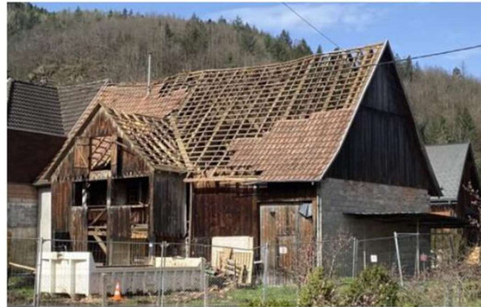
Malgré les protestations de l'Association du moulin de Storckensohn, la maison Dennecker est actuellement en cours de démolition. Photo DR
