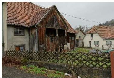
Le bâtiment fait l'objet d'un arrêté de péril. Photo François Froely
